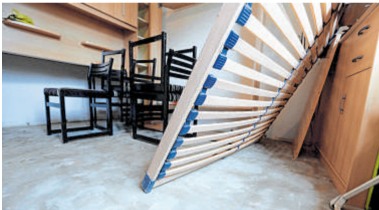
Nach einem Wasserschaden musste der komplette Fußboden aus der Wohnung entfernt werden.
